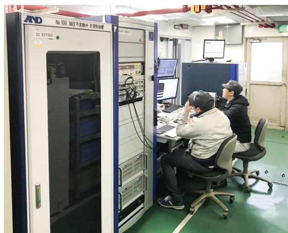
A&D製 油圧可変動バルブの制御盤
