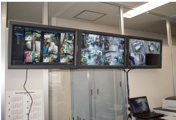
大黒センターの事務室でセンター内の様子を確認しています
